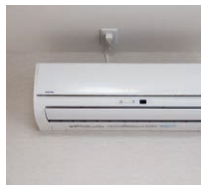
居室エアコン(冷暖房)
