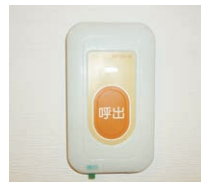
緊急通報装置(2箇所)
