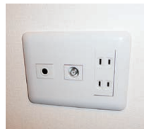
電話線用配管
