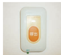
緊急通報装置(2箇所)
