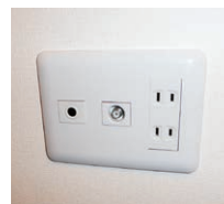
電話線用配管
