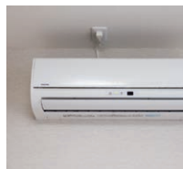
居室エアコン(冷暖房)
