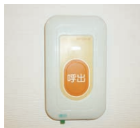
緊急通報装置(2箇所)
