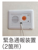
緊急通報装置 (2箇所)
