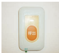
緊急通報装置(2箇所)
