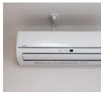
居室エアコン(冷暖房)
