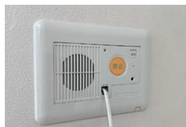
緊急通報装置(2箇所)
