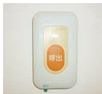
緊急通報装置(2箇所)
