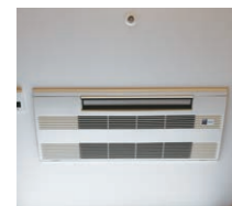
居室エアコン(冷暖房)
