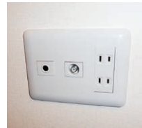
電話線用配管
