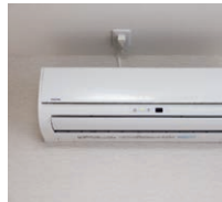
居室エアコン(冷暖房)
