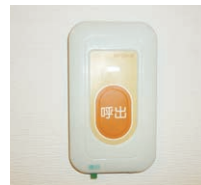
緊急通報装置(2箇所)
