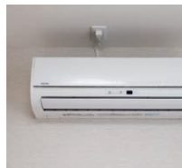
居室エアコン(冷暖房)
