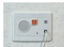
緊急通報装置(2箇所)
