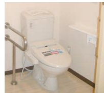
暖房便座付トイレ
