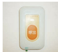
緊急通報装置(2箇所)
