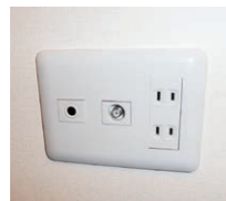
電話線用配管
