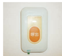
緊急通報装置(2箇所)
