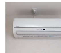
居室エアコン(冷暖房)
