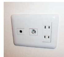
電話線用配管
