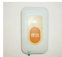
緊急通報装置(2箇所)
