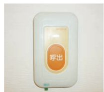
緊急通報装置(2箇所)
