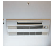
居室エアコン(冷暖房)
