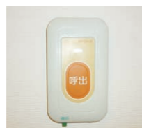
緊急通報装置(2箇所)
