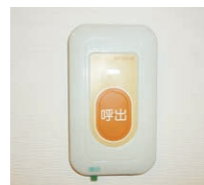
緊急通報装置(2箇所)
