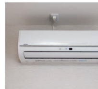
居室エアコン(冷暖房)
