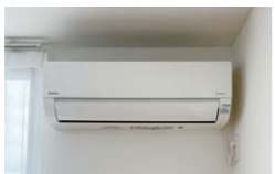
居室エアコン(冷暖房)
