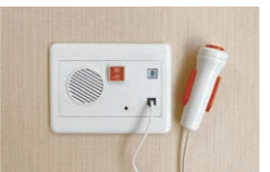
緊急通報装置(2箇所)
