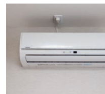
居室エアコン(冷暖房)
