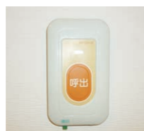
緊急通報装置(2箇所)
