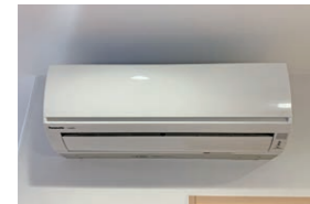
室内エアコン(冷暖房)
