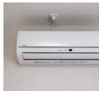
居室エアコン(冷暖房)
