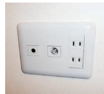
電話線用配管
