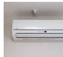
居室エアコン(冷暖房)
