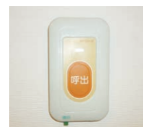
緊急通報装置(2箇所)
