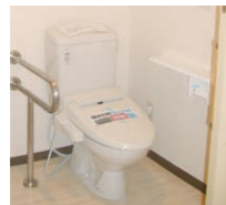
暖房便座付トイレ
