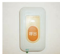
緊急通報装置(2箇所)
