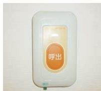
緊急通報装置(2箇所)
