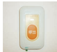
緊急通報装置(2箇所)
