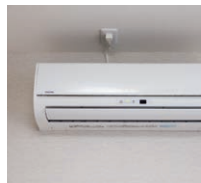
居室エアコン(冷暖房)
