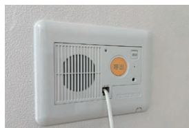
緊急通報装置(2箇所)
